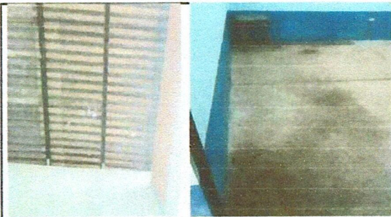
Sustitucion delaminas por agujeros y humedad en el piso de las instalaciones las cuales afectan en los días de clases
